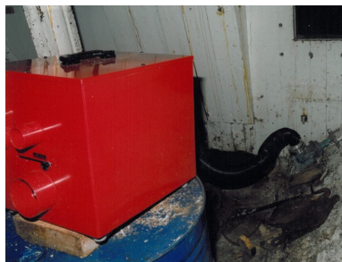
En avfukter som virker etter adsorpsjonsprinsippet. Denne ble brukt mens M/J Anne Bro stod på slipp ved Nordnorsk Fartøyvernssenter. Den fuktige lufta fra avfukteren gikk gjennom den sorte slangen, og ut via ei skrog-gjennomføring - ikke tilrådelig løsning om fartøyet ligger på sjøen.
