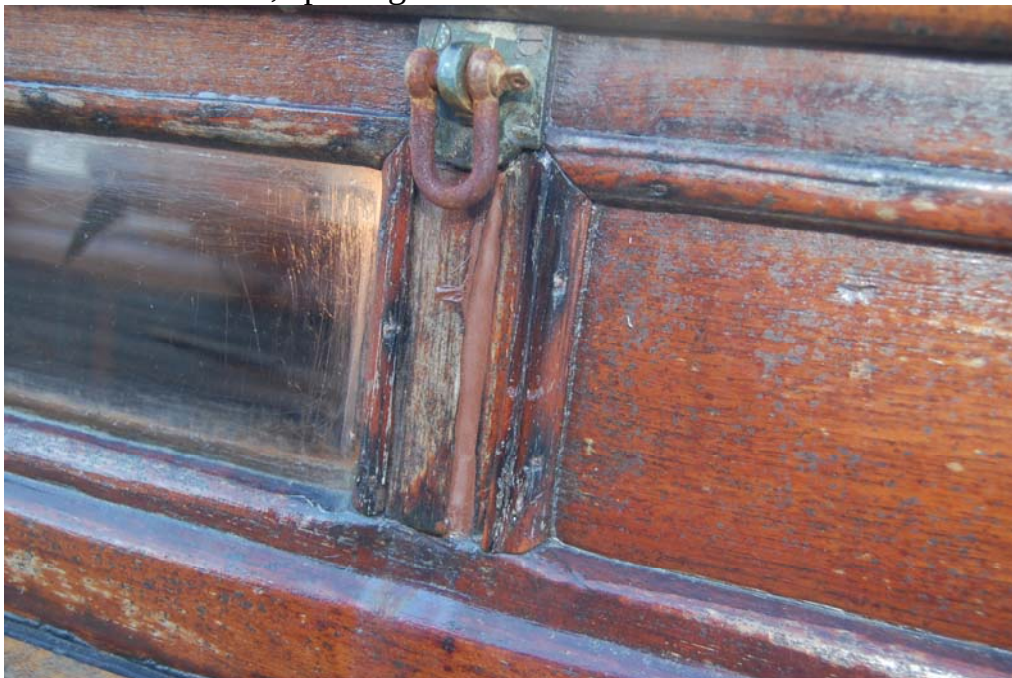
Stolpene er sprukne, muligvis på grunn av de rustne jernbolter inne i stolpene
