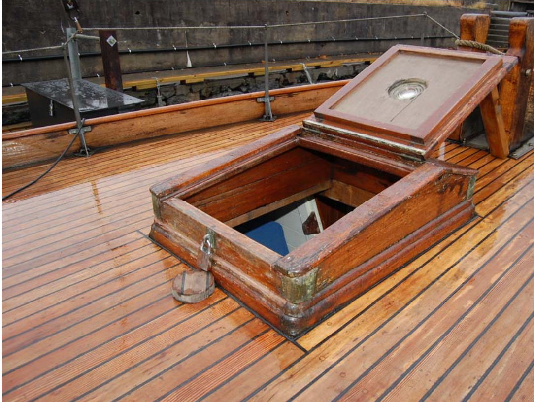
Forluken. Hjørnene er dårlige og reparert med messingplater. Kryssfinerplaten i lokket er av nyere dato
