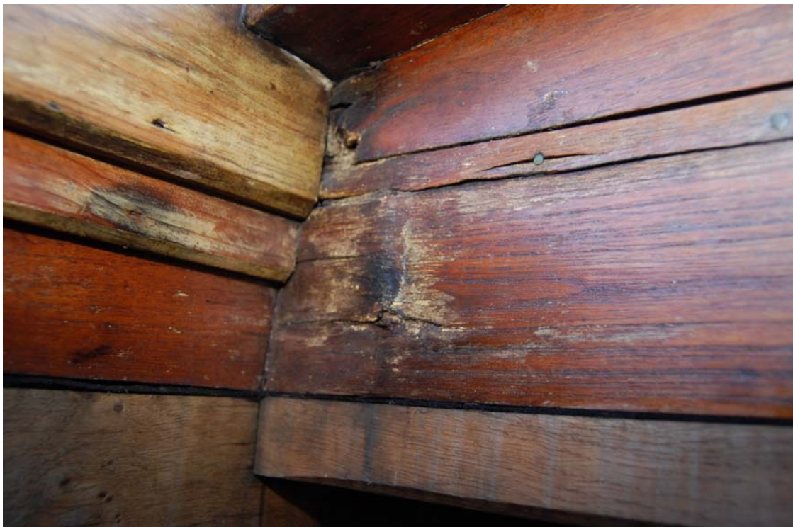
Innvendig hjørne i forluken på styrbord side akter. Treverket er sprengt av en rusten bolt
